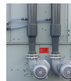
Pompa di riserva
