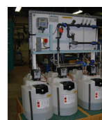
Apparecchiatura per il trattamento dell'acqua
