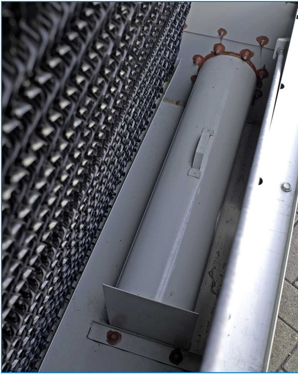
Bassin d'eau froide et tamis
